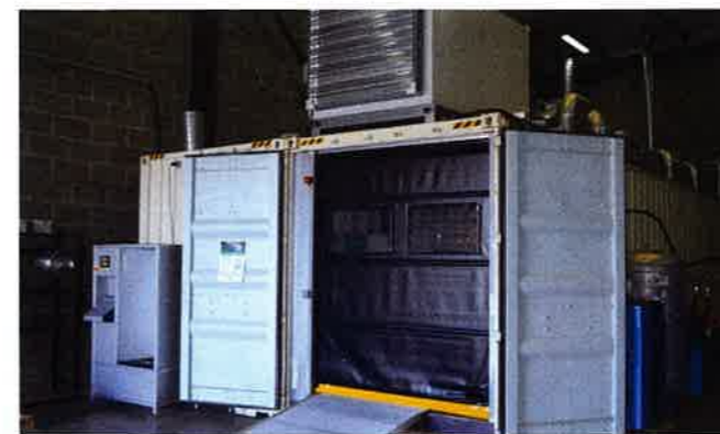
Installée dans un container, cette zone de production est ainsi entièrement, et à moindre frais, transposable dans un autre site.
